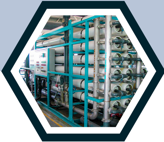
Sistemas de filtración
